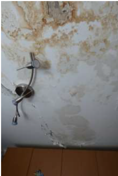
Foto 8 Le infiltrazioni sul soffitto della camera
